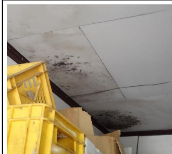
9.天井の雨漏り跡
