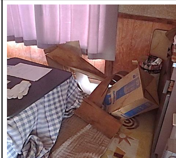
8.ベニヤの天井板の剥がれ
