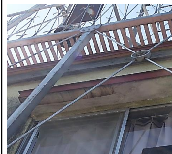
6.底の天井板の剥がれ
