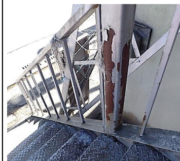
5.外階段の錆び
