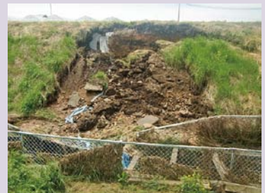
柳沢丸山せぎ地区畑法面崩落
