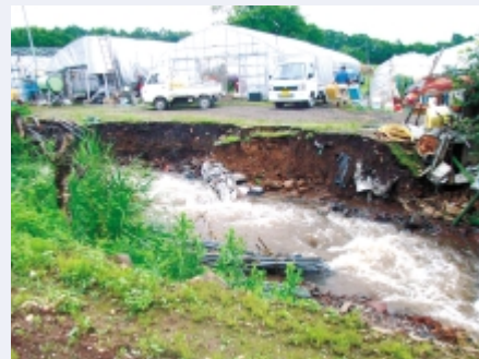
阿久川の護岸崩落 (平成18年7月豪雨災害)
