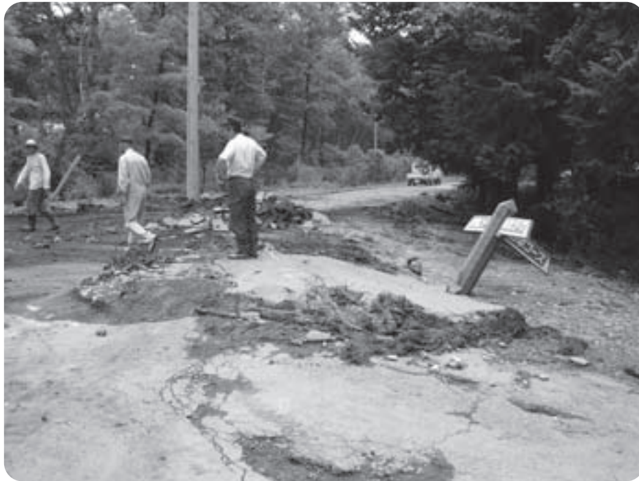
7月1日集中豪雨による被害
