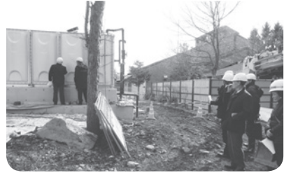
もみの湯温泉タンク(新設)
