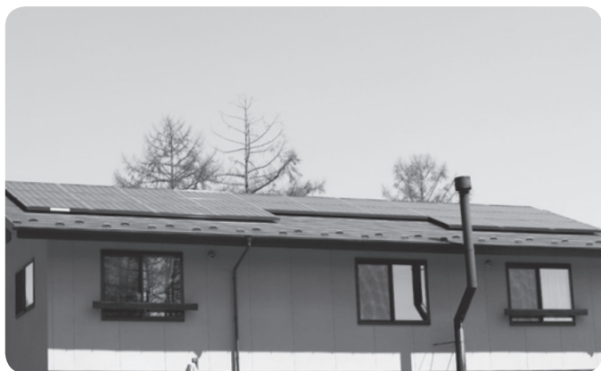
太陽光発電システム
