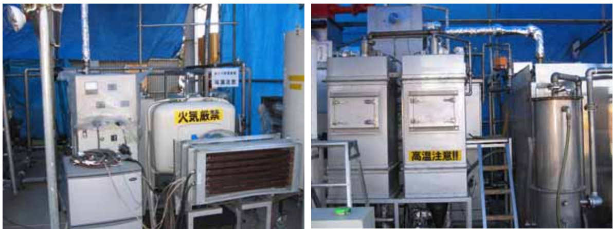
熱分解ガス化発電プラントの外観
