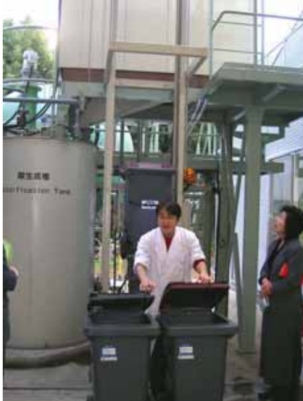
酸生成槽と生ごみ回収箱、溶解槽（上部）
