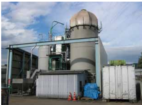
バイオガス化施設
