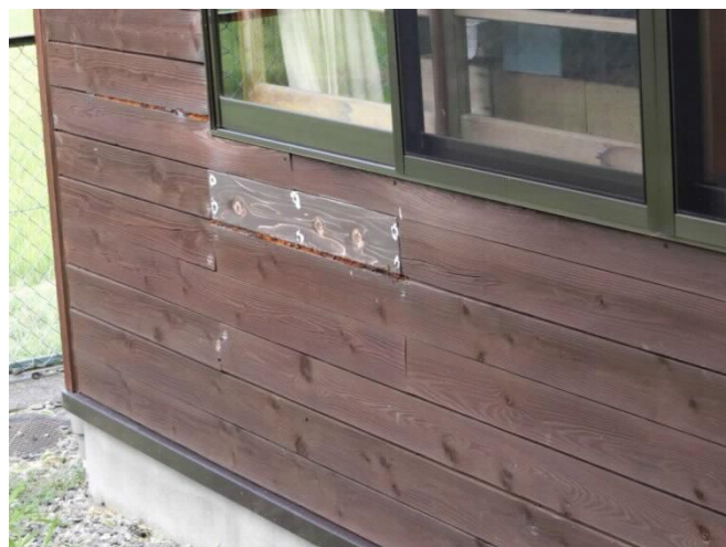
写真 4 剥離した外壁板（増築）
